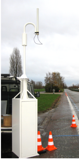
FIGURE 1.1 – La borne de l’infrastructure
